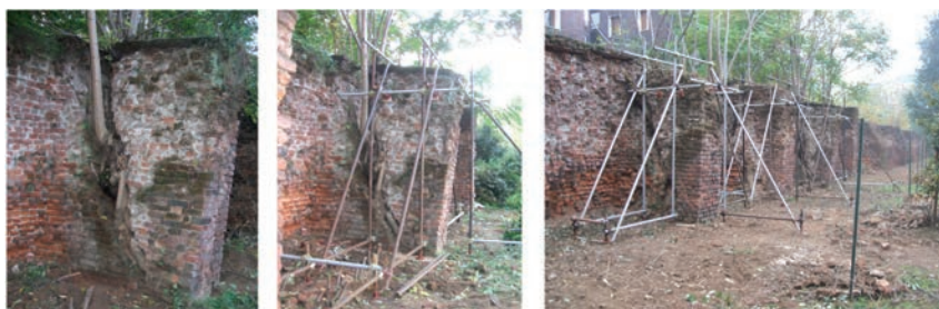
Fig. 9 – Sequenza fotografica della messa in sicurezza dei barbacani a rischio di crollo, tratto T3 corrispondente al cavaliere di viale Filippetti.
