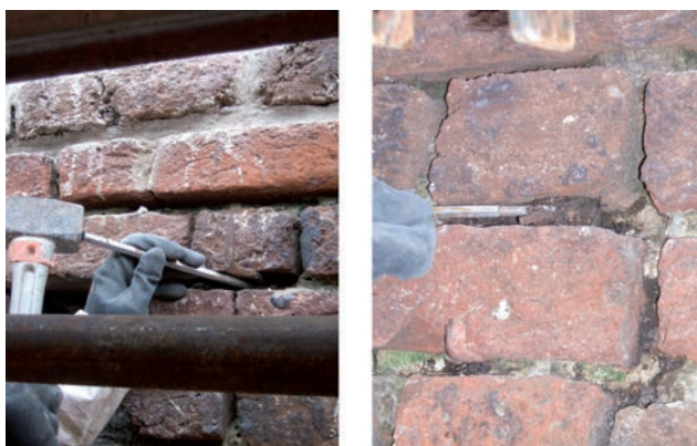
Fig. 13 – Fase di rimozione delle malte di allettamento e di stilatura non più idonee.
