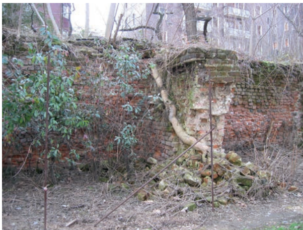
Fig. 7 – Fotografia del 2006, barbacane del tratto T2 di viale Filippetti; in particolare è evidente il danno prodotto da una grossa radice.
