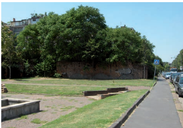
Fig. 8 – Fotografia del 2006, fianco del cavaliere del tratto T3 di viale Filippetti; è visibile la crescita incontrollata di arbusti di grandi dimensioni, alloggiati in particolare modo all'interno del fianco, che si comporta come una “vasca” di contenimento.
